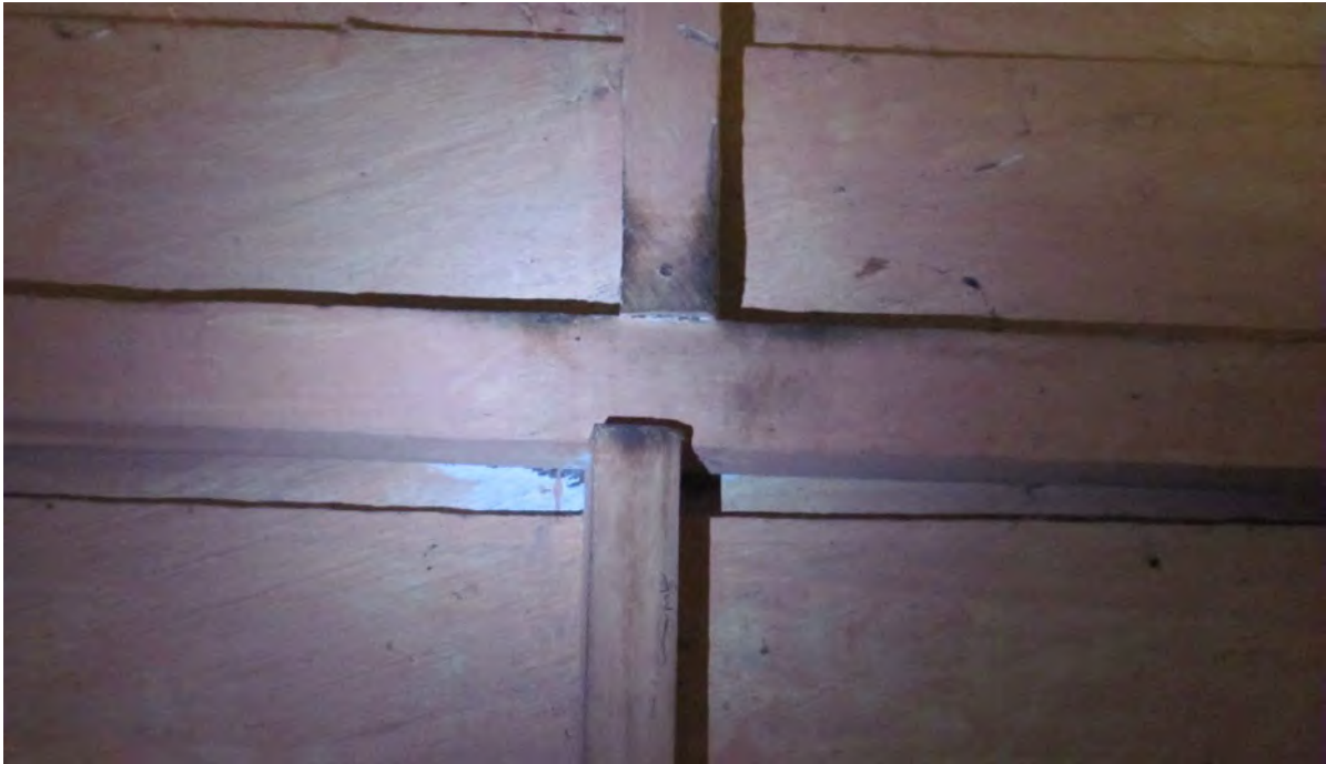
Imagen 17. Los recorridos de Rattus rattus en forma reiterada a lo largo de vigas, paredes o cañerías determinan la aparición de manchas de grasa que son producto del contacto del cuerpo del animal con una superficie. Son de aspecto negruzco y se hacen más evidentes en los puntos donde el individuo debe pivotar alrededor de un obstáculo, produciendo marcas semicirculares particularmente intensas, como se aprecia en la fotografía.
